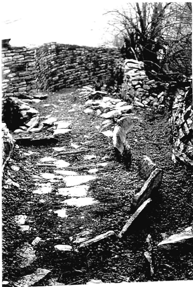
8. Βραδέτο: τμήμα του αγωγού ομβρίων υδάτων που χρησιμοποιούνται για καθαρισμό των αποχωρητηρίων
